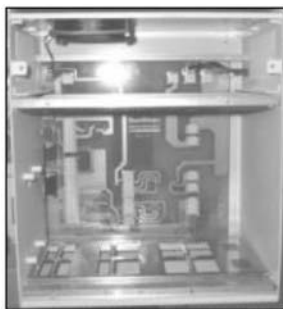
Внутри блока управления
